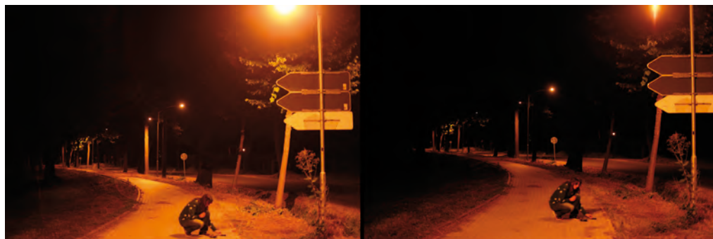
Abb. 4: Im Jahr 2021 wurde in der Fuldaaue eine adaptive Radwegebeleuchtung installiert, die im Grundzustand (rechts) eine Beleuchtungsstärke von ca. 8 lx erzeugt, bei Annäherung einer Person oder eines Radfahrers wird diese auf ca. 18 lx verdoppelt; Fotos: A. Hänel.
