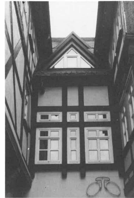
Abb. 7.8 Moderne Fenster haben trotz Sprossen völlig andere Proportionen Foto York Kautt
