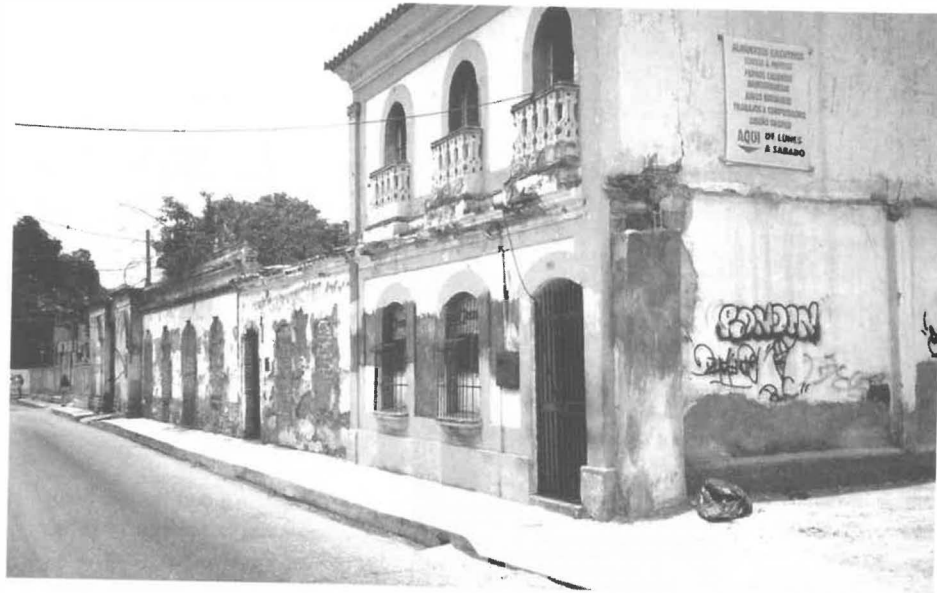
Abb. 5: Vom Verfall bedrohte Patio-Häuser in der Altstadt von Barquisimeto; Foto: A. Thierer 2003.
