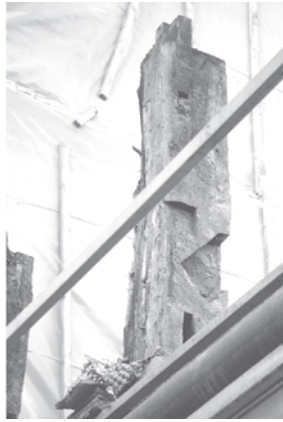
Abb. 6: Das Haus Kurze Geismarstraße 30 im Oktober 2004. Rechts einer der während des Abrisses sichtbaren Fassadenständer mit seitlichen Ausnehmungen für Kopfband und Brustriegel. Auf der Vorderseite ist im oberen Bereich am helleren Holz der Rest der abgesägten Knaage zu erkennen.
