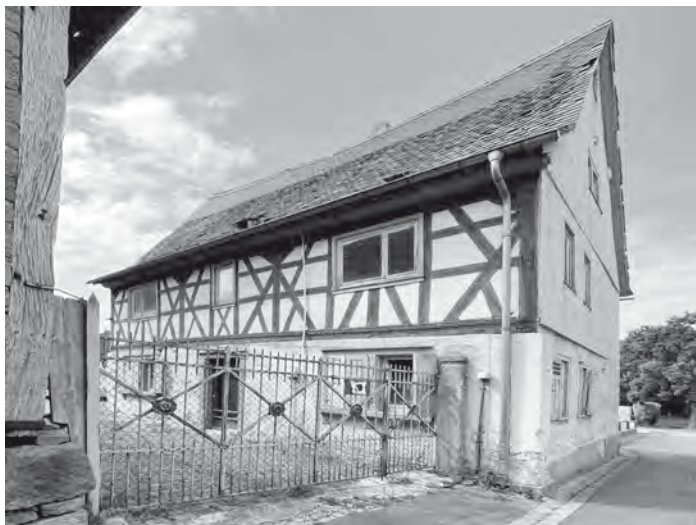
Abb. 2: Verfall historischer Bausubstanz im Landkreis Darmstadt-Dieburg. Foto: TU Darmstadt, WieBauin: N. Labidi.
