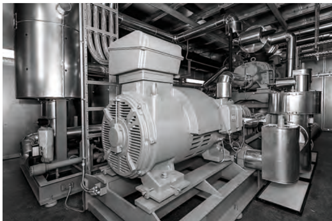
Abb. 3: Großwärmepumpe, die Abwasser zu Fernwärme umwandelt in Lemgo; Foto: Michael Reimer, Stadtwerke Lemgo GmbH.
